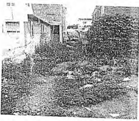
Registro fotográfico donde se muestra el Estado de Maleza y sedimentación del canal.
