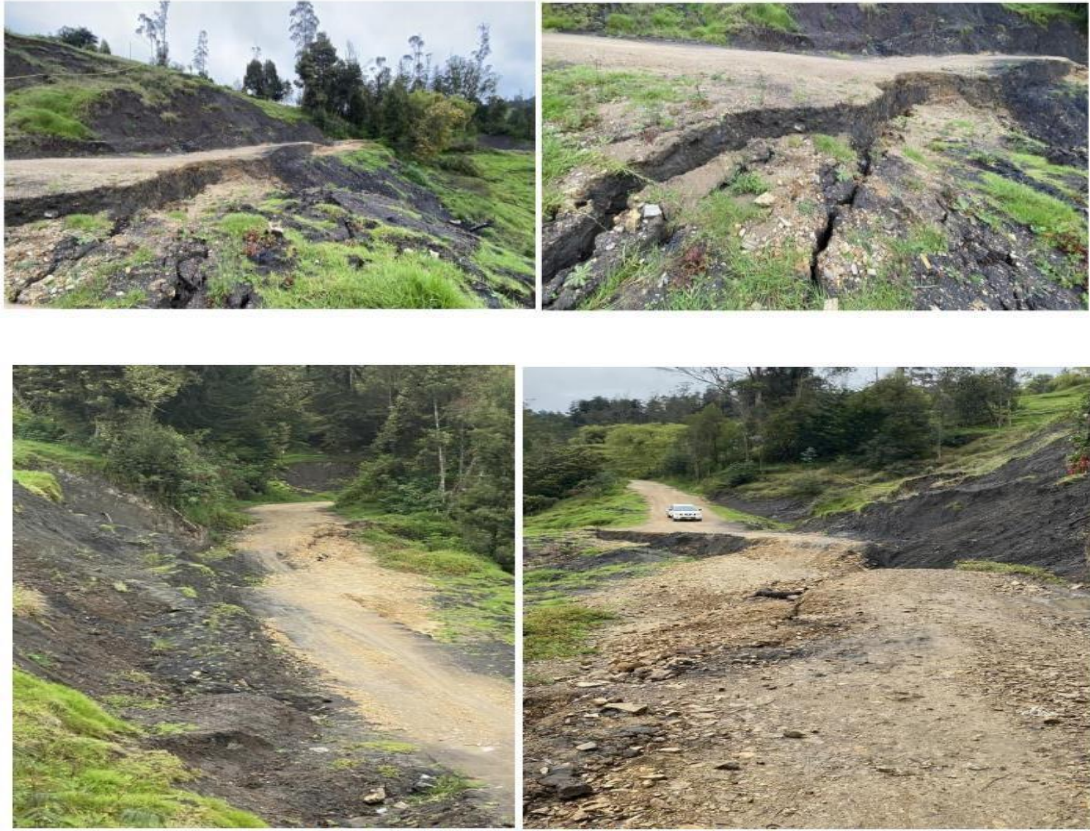
Figura 4. Punto crítico en la vía Viracachá – Cienega. 5°25'22.62"N- 73°16'54.10"O
