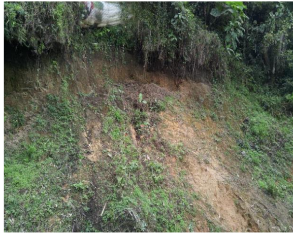
TALUD AFECTADO EN EL SECTOR LA TRAVESÍA
