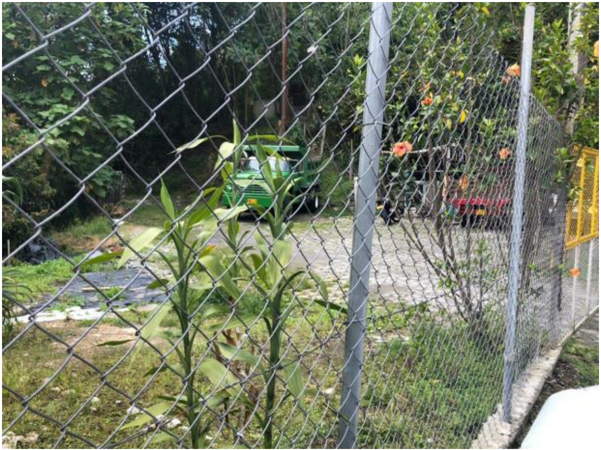
Fotografía No 1. Se evidencio la construcción de un cerramiento con malla eslabona invadiendo una bien privado el cual están utilizando como parqueadero de vehículo pesado
