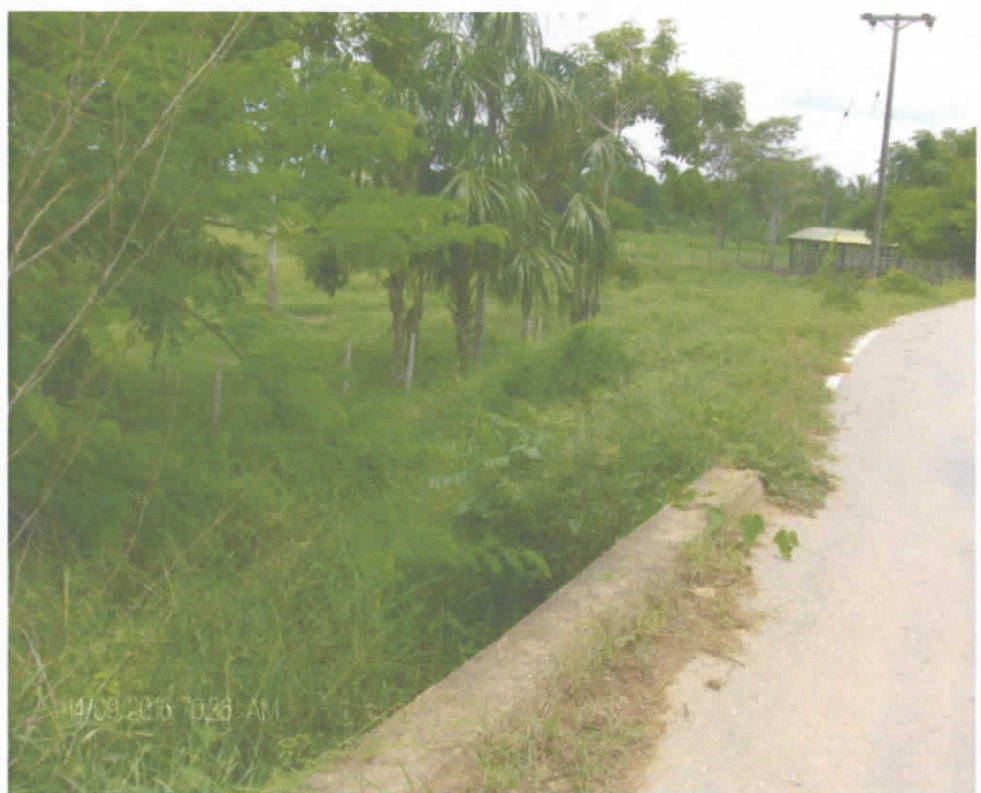
Bordillo del puente o pontón, en concreto rígido. Al fondo, corral con techo, de la finca colindante a la vía. Se observa cómo está dentro de la vía.
