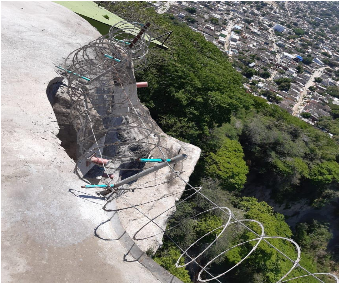
Foto N° 5: Detalle del borde revestido en concreto del Salto del Cabrón. Al fondo a la derecha, parte del barrio La Quinta.
