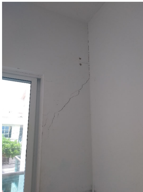
Fotografía 6. Fisuras por deflexiones.
