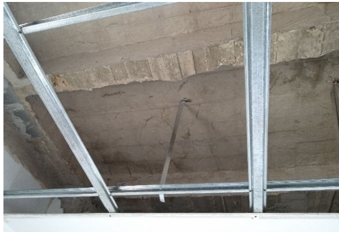
Fotografía 4. Deformación en sección de viga.
