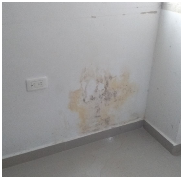
Fotografía 2. Humedades por filtración en muro y losa.
