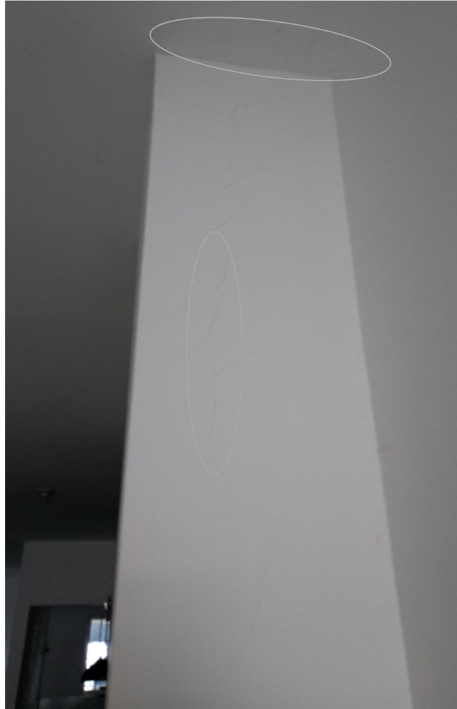
Fotografía 5. Fisura en la intersección entre muro y losa.
