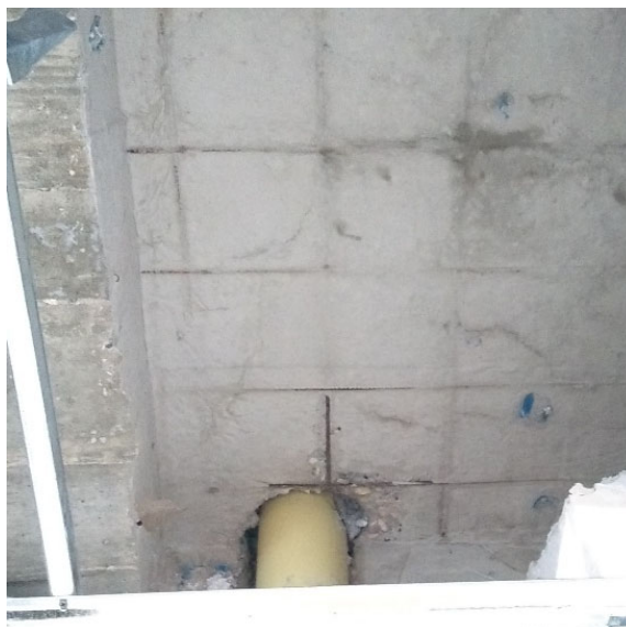
Fotografía 7. Corrosión y oxidación en acero de la losa.
