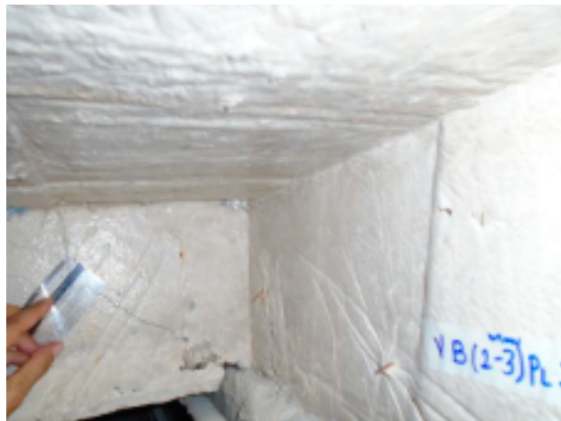
Fotografía 8. Fisura por cortante en viga.
