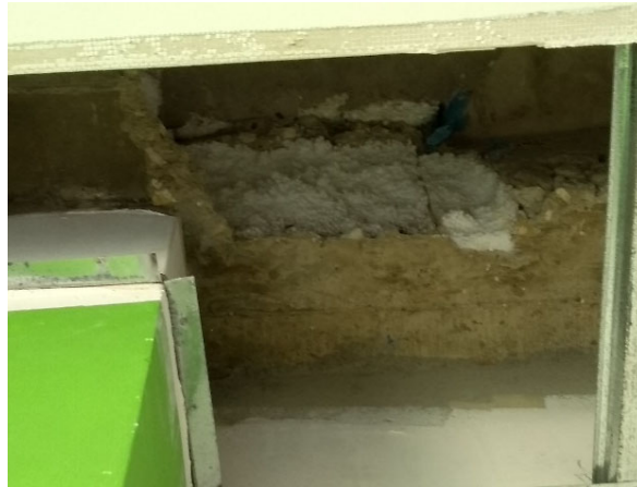
Fotografía 3. Hormiguero en viga.
