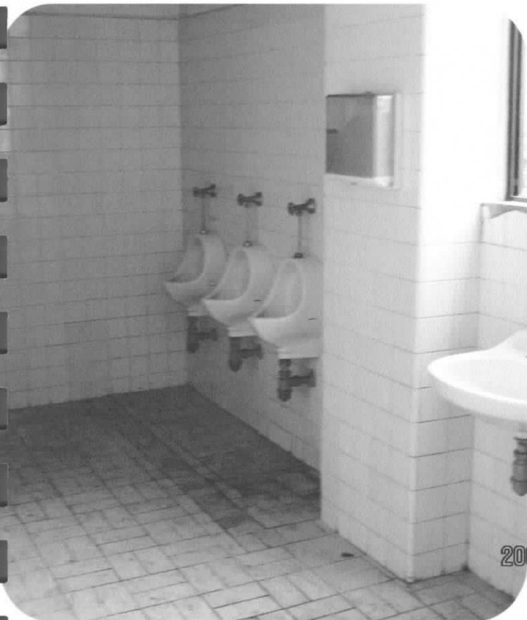
BATERIA DE BAÑOS BATERIA DE BAÑOS
