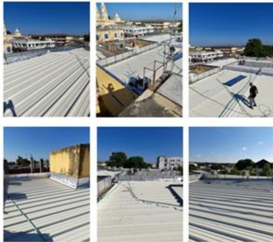
Imagen 1. Trabajos de reparación e impermeabilización en el Palacio de Justicia de Sabanalarga
