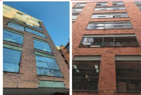
Estado de la fachada
