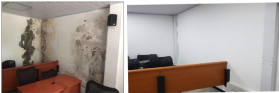
Estado (Antes y después) de algunas humedades
