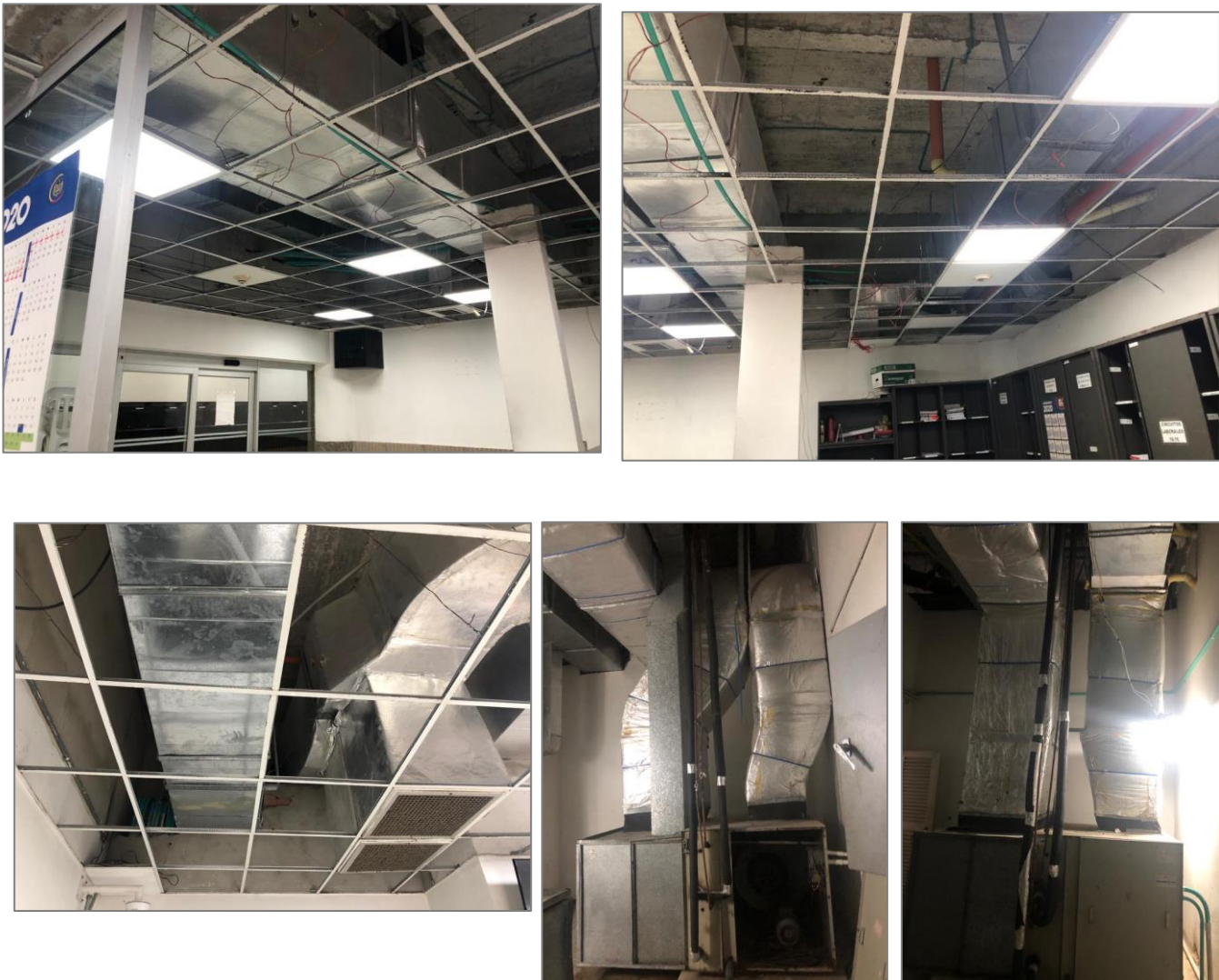
Foto 1. Estado de los conductos de aire acondicionado piso 1 – Edificio Centro Cívico.
