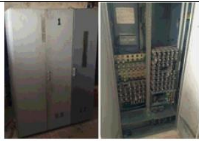
Panel de Control Actual*
