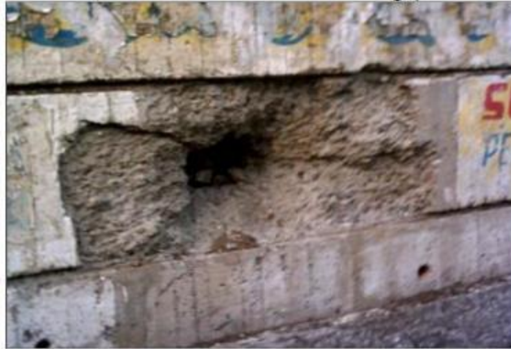
Imagen 10. Fracturamiento del concreto y pérdida de la sección por impacto de un objeto. Muro de Contención, Carretera Buenaventura-Buga. Fuente: (INVIAS, 2006).
