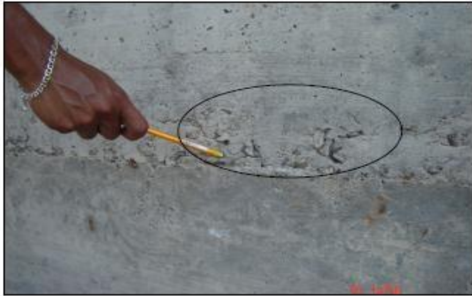
Imagen 3. Segregación en un muro. Vía Simití- Centro de Burgos, Bolívar. Fuente: (INVIAS, 2006).
