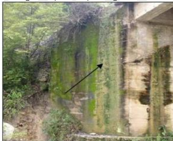
Imagen 9. Contaminación del concreto de las aletas. Puente Río Meldar, Tolima. Fuente: (INVIAS, 2006).
