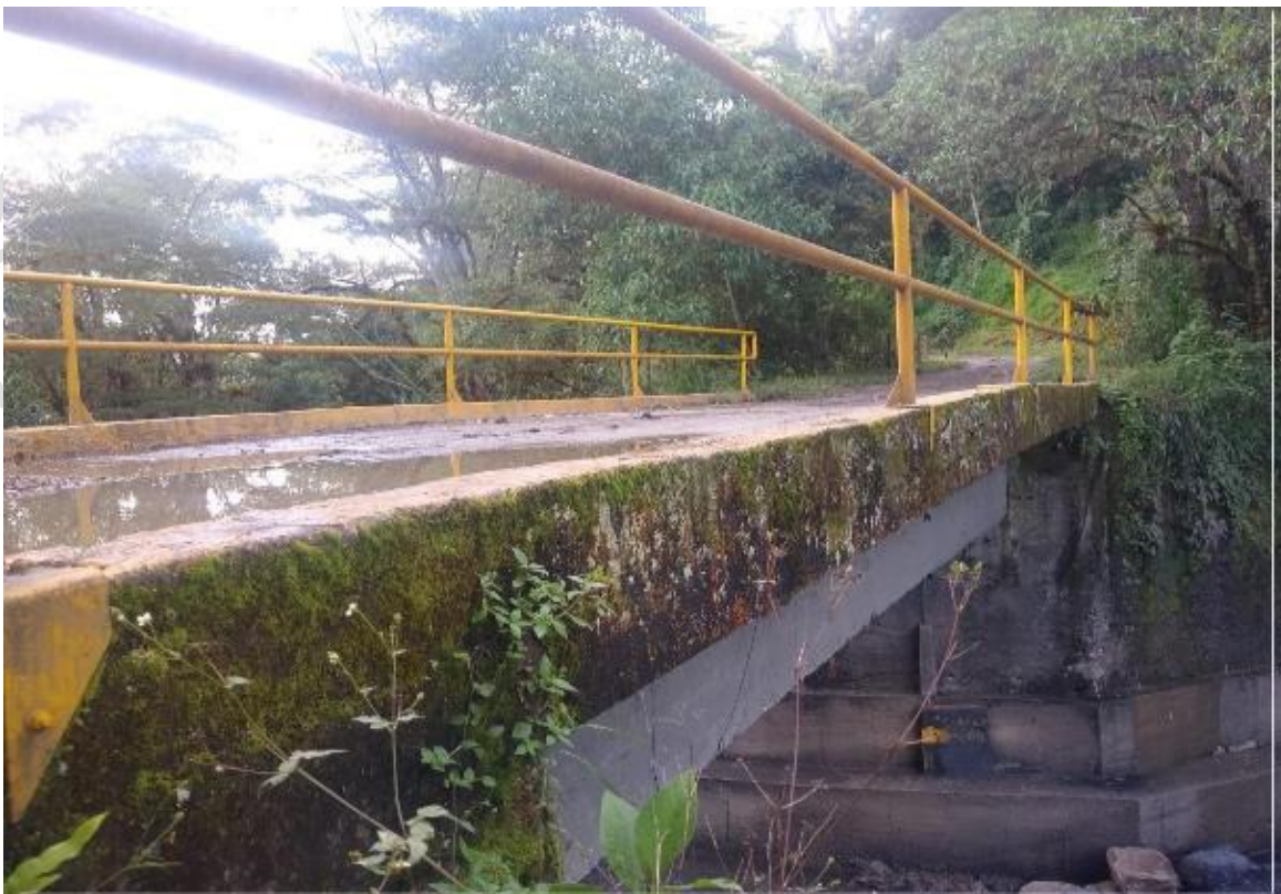
Foto No.5. Presencia de material vegetal y eflorescencia de color verde oscuro
