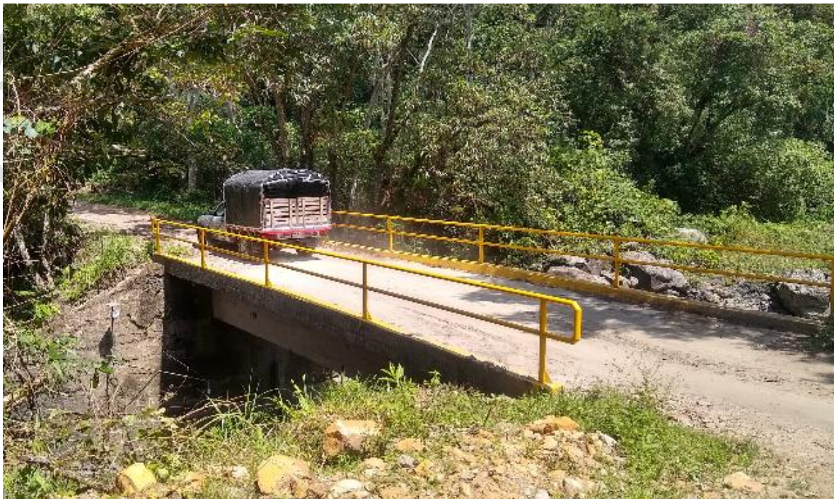
Foto No.10 Ancho no adecuado del puente para su uso, sin señalización.
