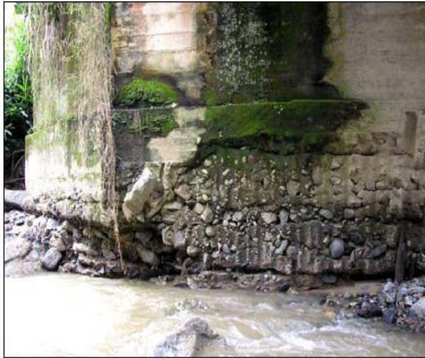
Imagen 11. Socavación en un estribo. Puente Meldar, Tolima. Fuente: (INVIAS, 2006).
