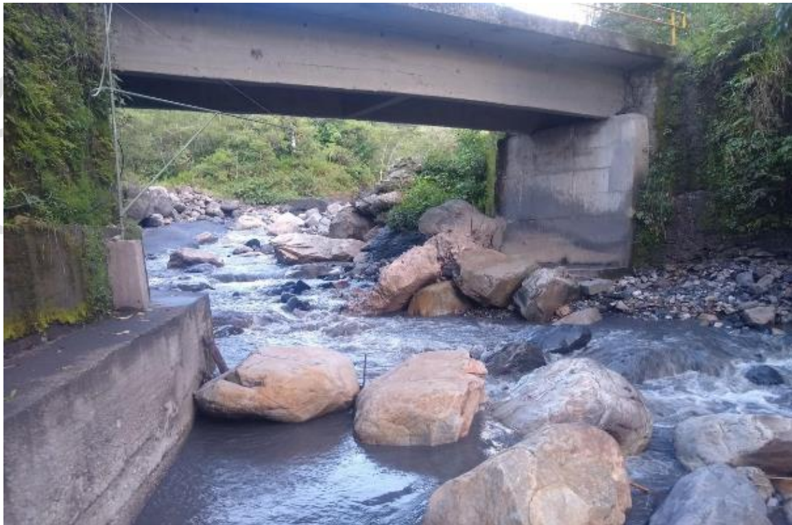
Foto No.7. Obstrucción del cauce por rocas de gran tamaño.
