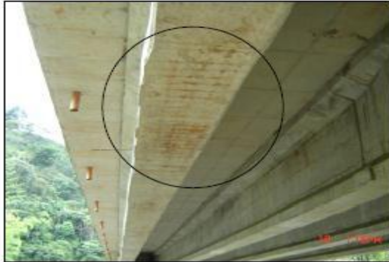
Imagen 8. Evidencia de manchas de óxido en la superficie del concreto. Puente sobre el Río Quindío. Fuente: (INVIAS, 2006).
