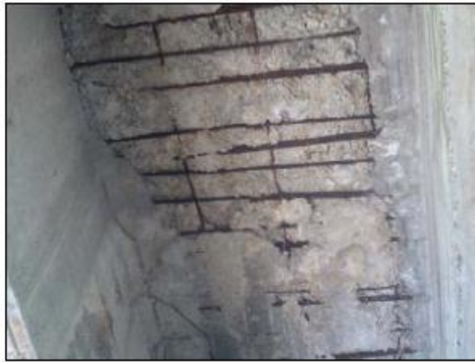
Imagen 6. Recubrimiento inadecuado en la losa, exposición del acero de refuerzo y corrosión del mismo. Puente Q. Las Ánimas, Chocó.
