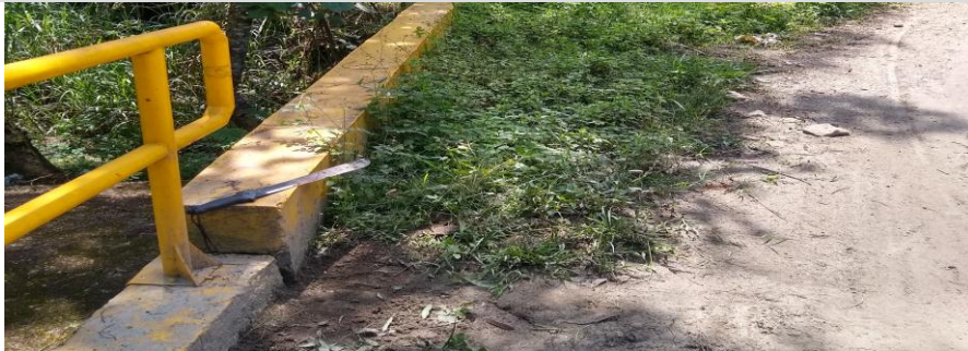
FOTOGRAFIA DE LA ALFECTACION
