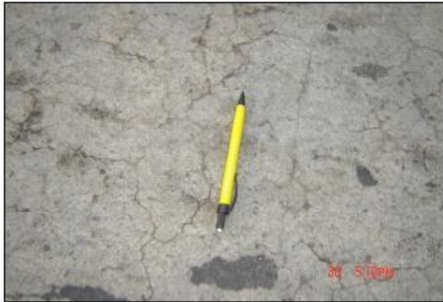
Imagen 4. Fisuración por retracción hidráulica. Puente Luis Ignacio Andrade, Tolima.
