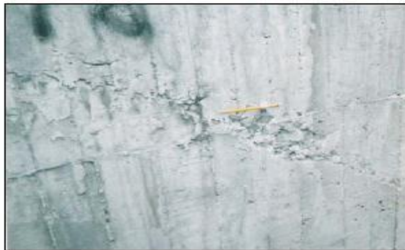
Imagen 5. Junta fría construida inadecuadamente. Fuente: (INVIAS, 2006)
