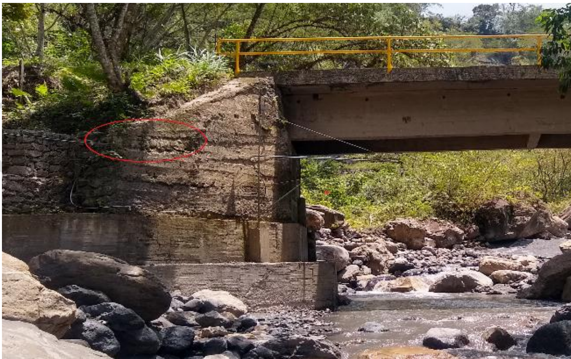
Foto No.14 Fallas en procesos constructivos hormigoneo en aletas.
