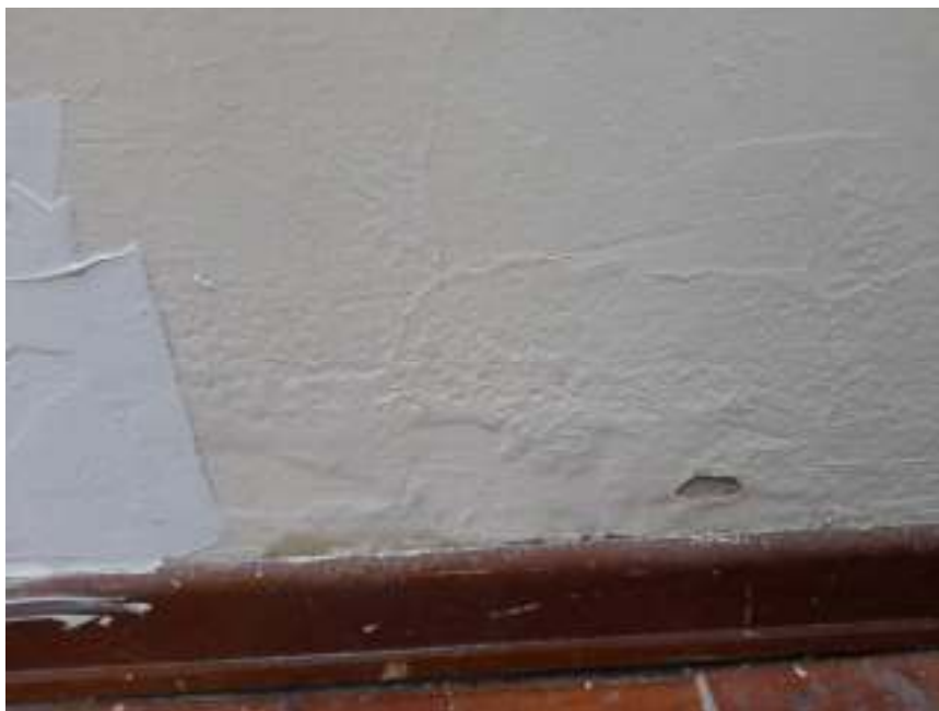
Humedad en muro de patio.
