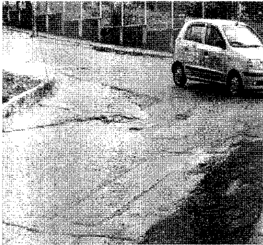
Huecos en las vías desde la carrera 8B 43 a -76 hasta la Carrera 8 48 -62.
