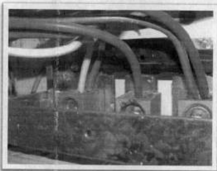
Entrada a tablero sin identificación de fases con el código de colores.
