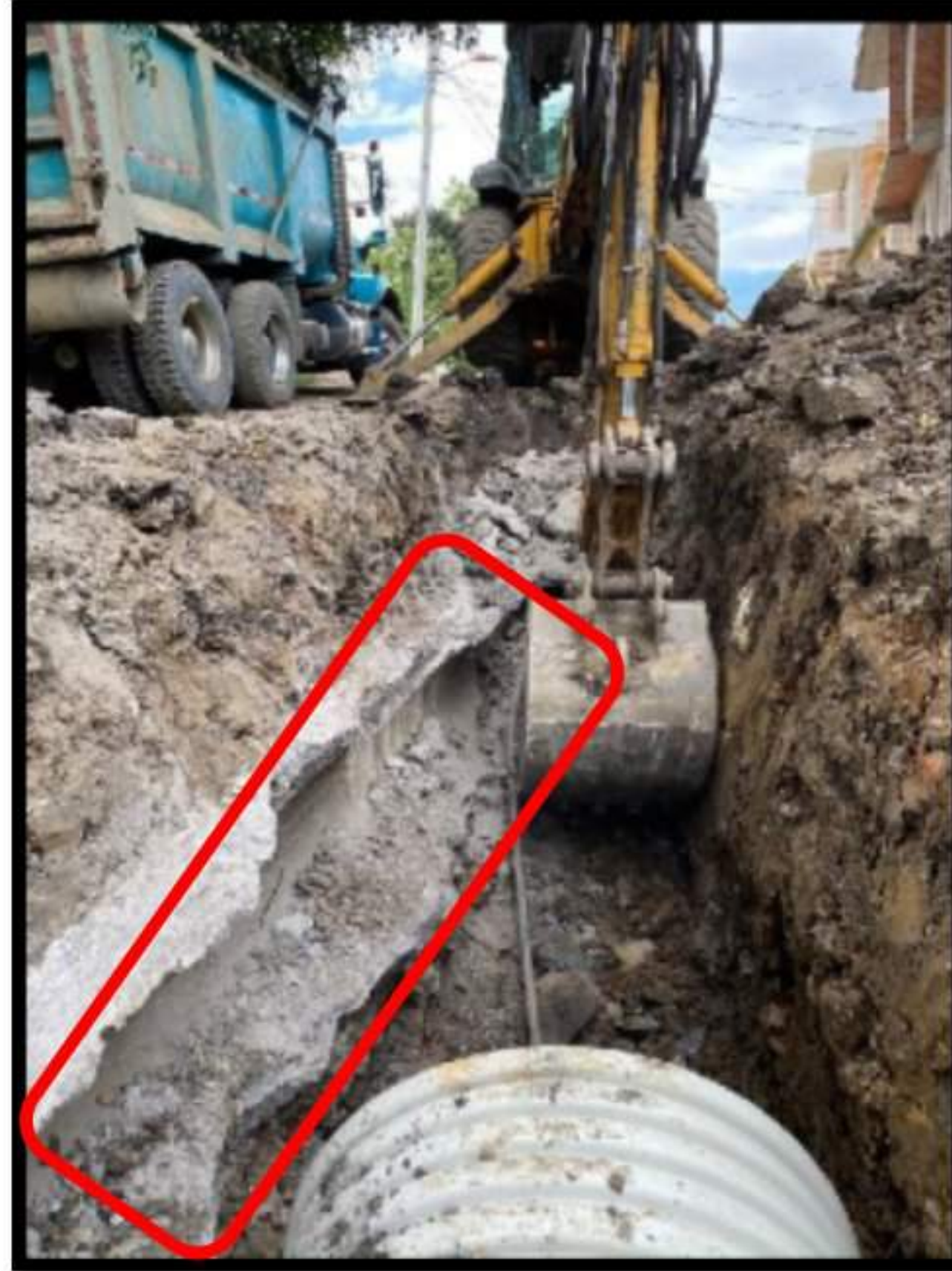
Imagen 1: Afectaciones a la red de 36" en concreto, por paso de red de 42" red pluvial
