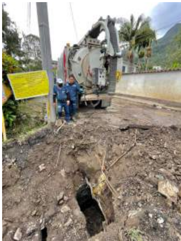
Imagen 22: Se rompió el frente de la propiedad y no se hicieron las obras para restablecer completamente
