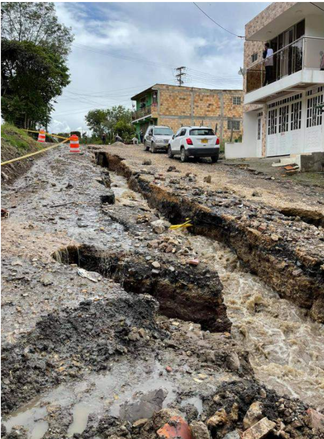
Imagen 24: Los daños causados por la emergencia afectan a muchos habitantes del casco urbano de Choachi.
