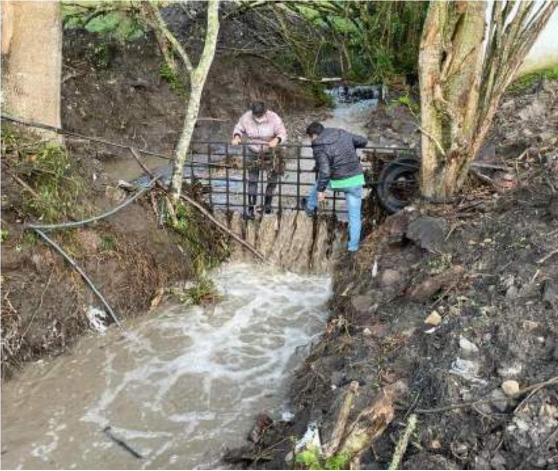
Imagen 17: La quebrada antes de entrar a la tubería ilegal alcanza caudales que la exceden
