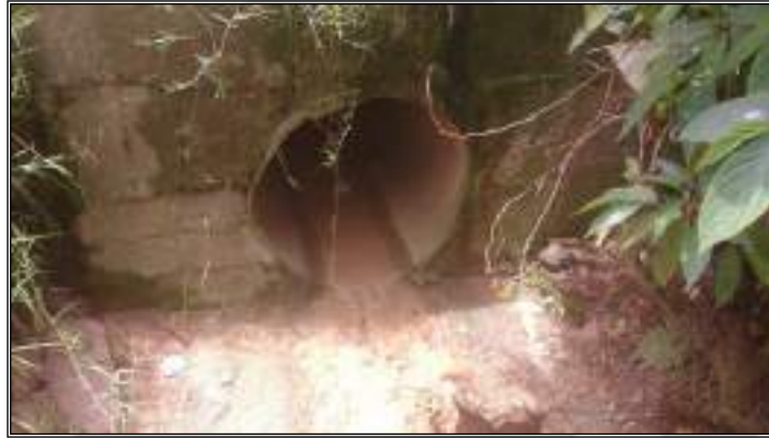
Foto No. 19 Cabezal de descarga Tubería de 42” en concreto.
