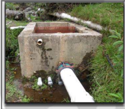
Foto No. 8 Caja de paso
