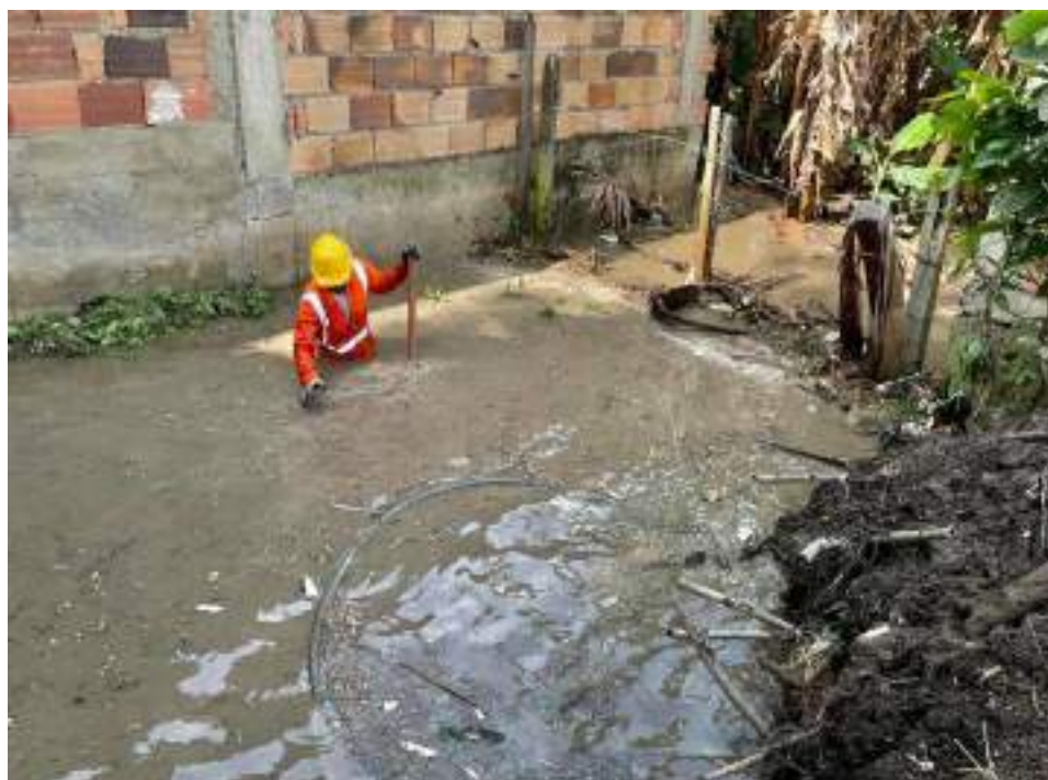
Imagen 21: La falta de mantenimiento y de monitoreo y las tuberías insuficientes incrementan los riesgos de la colmatación y el desbordamiento
