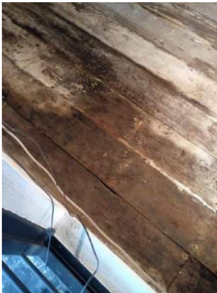
Imagen 25: Los daños causados por la emergencia al interior de la vivienda del lote 5 del predio vecino a la invasión por canalización ilegal en donde los pisos de madera quedaron inservibles y produjeron efectos de pudrición en medio de la infección por Covid 19.
