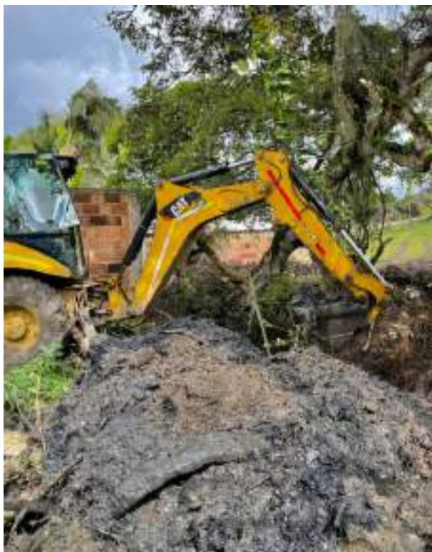
Imagen 19: Se evidencia la dimensión de la colmatación en la entrada a las canalizaciones ilegales de la quebrada Cucuaté
