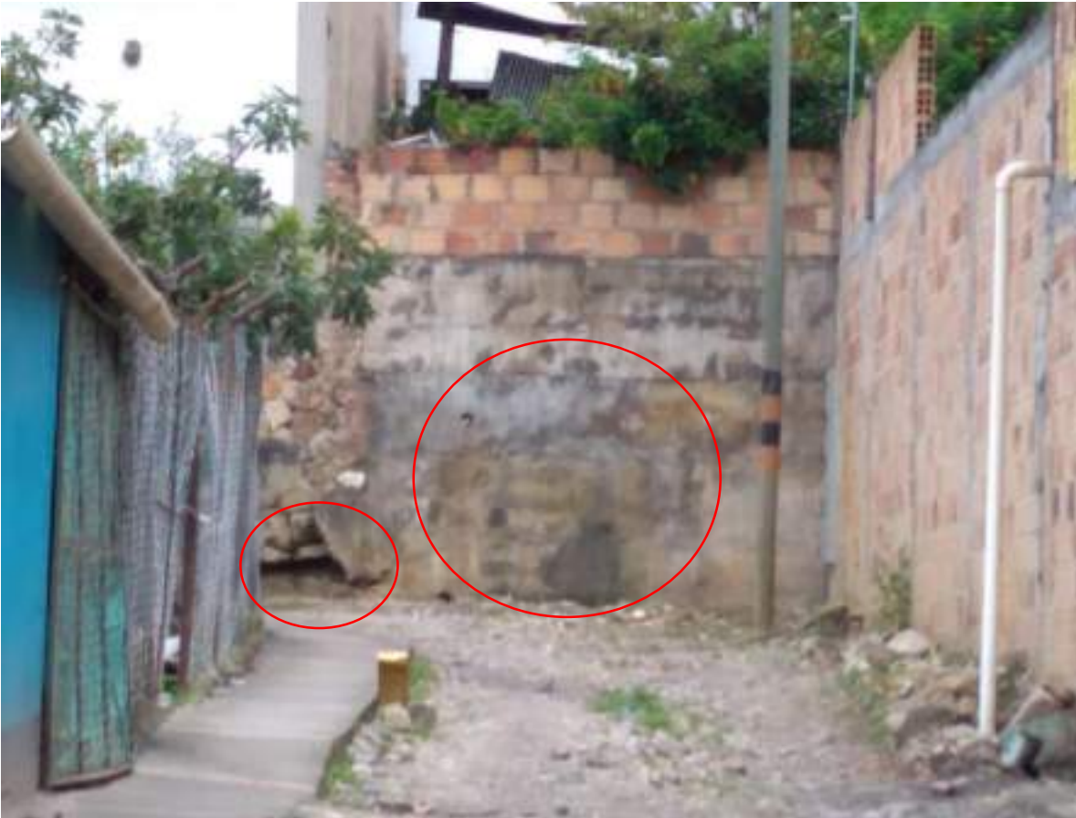
Imagen 5: El muro construido para bloquear el cauce natural de la quebrada el día de hoy presenta humedades importantes y deformaciones.
