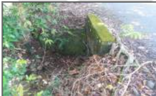
Foto No. 20 Cabezal de descarga Tubería de 24” en concreto.
