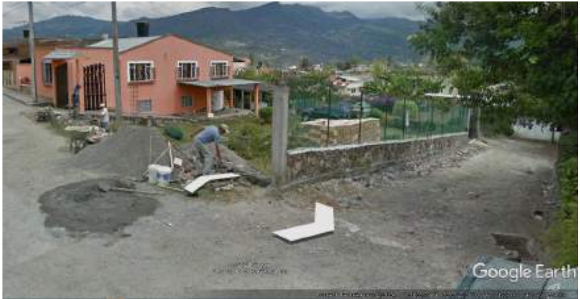
Imagen 3: Momento en que se cierra el paso al cauce natural. No hay cartelera informativa de licencia de cerramiento. GE streetView Enero 2013
