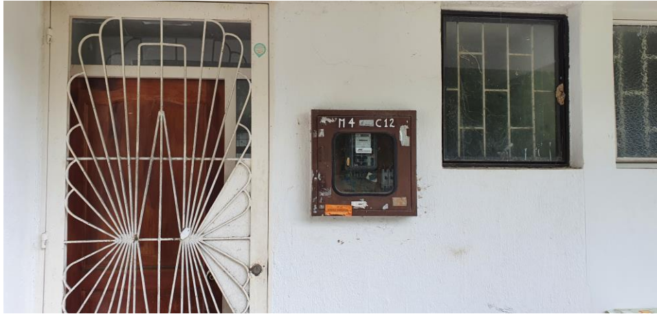
10. Medidor para energia
