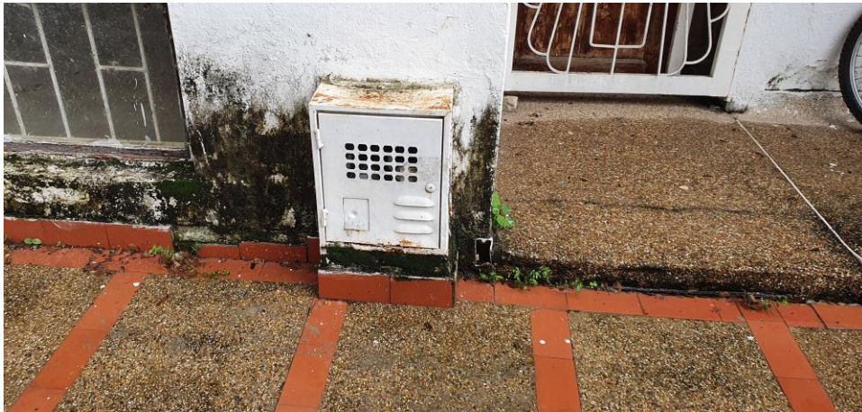
8. Medidor para gas
