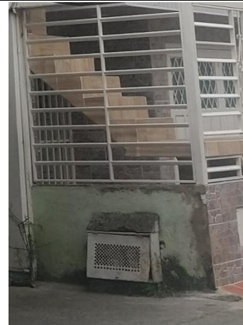
MEDIDOR DEL ENERGIA
