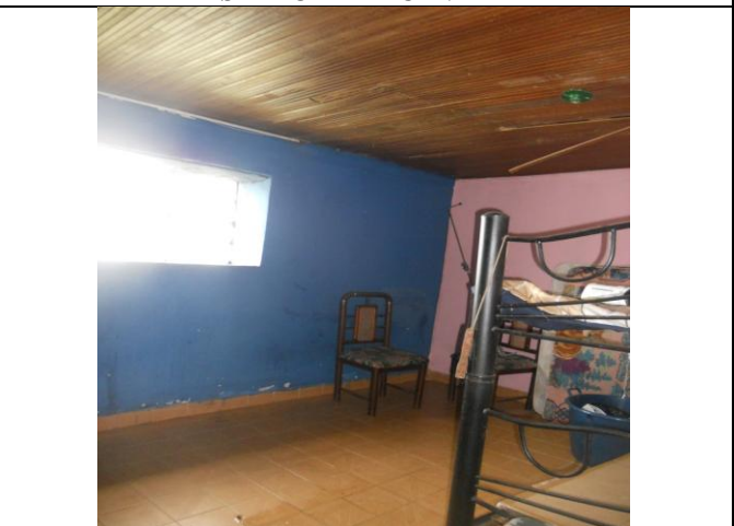
ACABADOS Y ESTADO DE ALCOBAS
