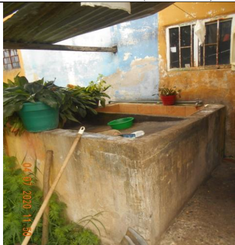
ESTADO DEL TANQUE LAVADERO
