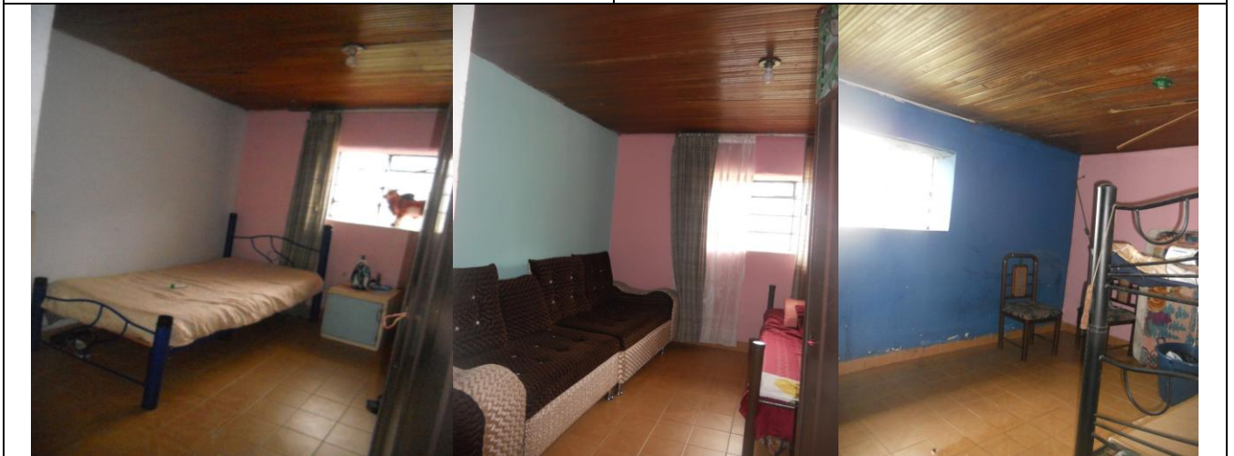
ACABADOS Y ESTADO DE ALCOBAS
