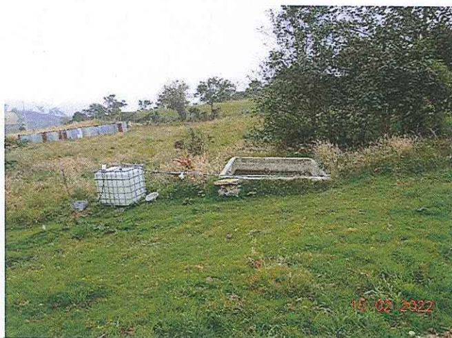
TANQUE DE RESERVA
