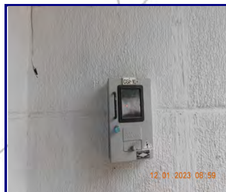
MEDIDOR PARA ENERGIA
