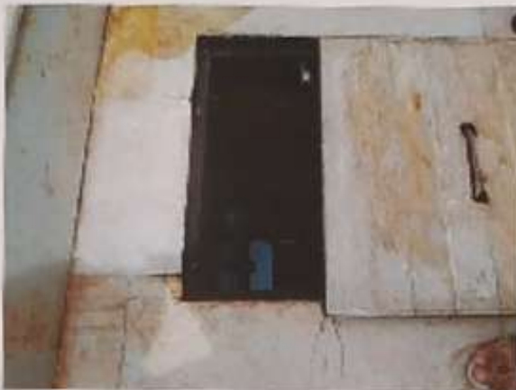
TANQUE DE RESERVA EN TERRAZA
