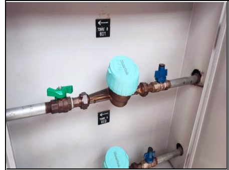
MEDIDOR DE AGUA
