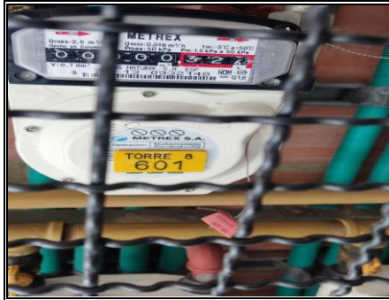
MEDIDOR DE GAS
