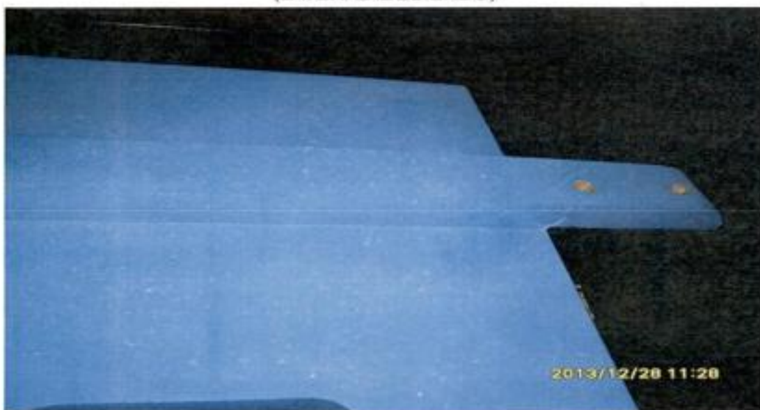
DETERIORO EN PUNTO DE FIJACIÓN DE LA BARANDA AL LARGUERO (LATERAL DERECHO)
