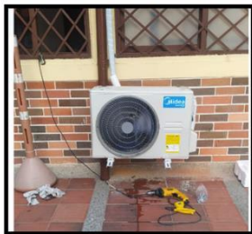
DIAGNOSTICO, MANTENIMIENTO PREVENTIVO Y/O CORRECTIVO, SUMINISTRO E INSTALACIÓN DE AIRES ACONDICIONADOS DEL DISTRITO JUDICIAL DE POPAYÁN, INCLUYENDO LAS OBRAS CIVILES A LAS QUE HAYA LUGAR ($196.653.497)
